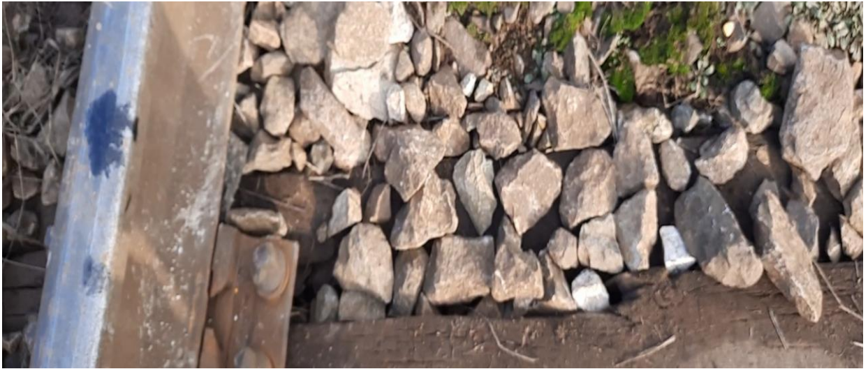
Imaginea nr.17- traversa T-1 sub firul interior al curbei, partea stângă a sensului de mers
