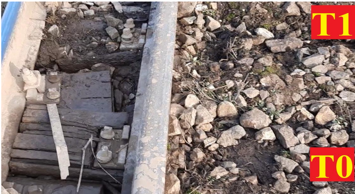
Imaginea nr.19 - traversele T0 și T1, partea stângă a sensului de mers, șina firului interior a curbei
