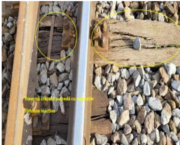
Foto.nr.16 – Traversa T-35
