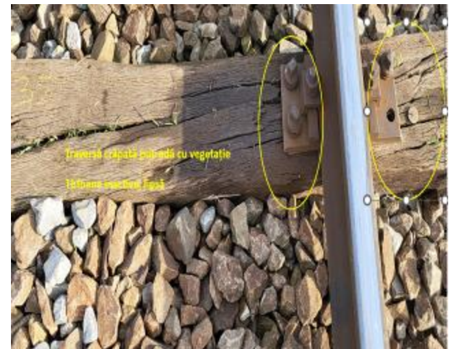
Foto.nr.17- Traversa T-35
