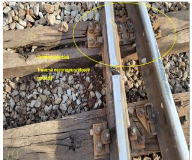
Foto.nr.11 – Traversa T-18
