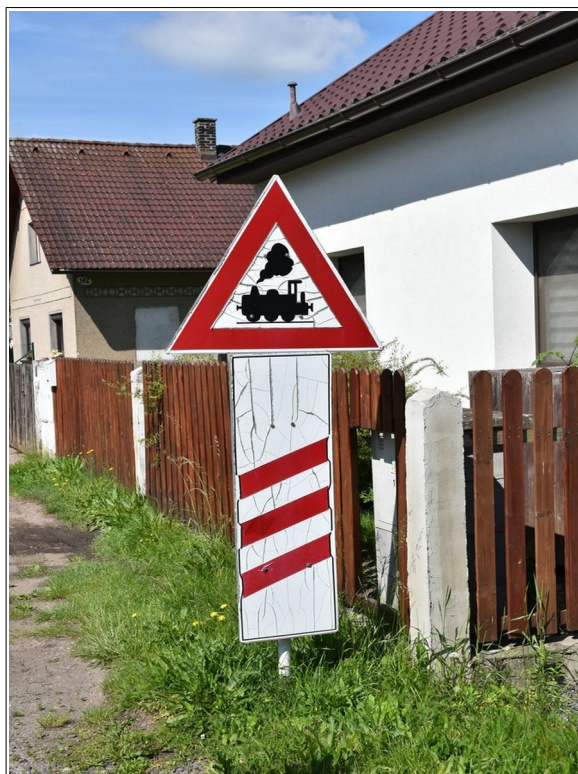
Obr. č. 2: Pohled na popraskané dopravní značení A 30 + A 31a umístěné ve vzdálenosti 219 m před ŽP Zdroj: DI
