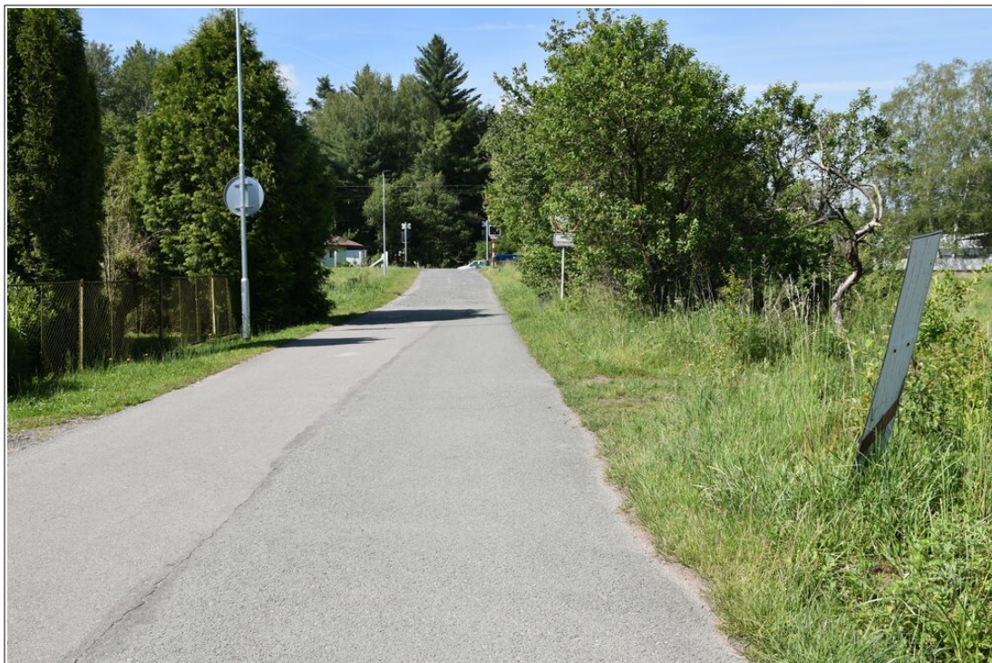
Obr. č. 3: Pohled na vyvrácenou a popraskanou návěstní desku A 31c umístěnou ve vzdálenosti 63 m před ŽP Zdroj: DI
