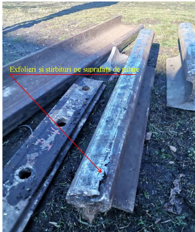
Foto nr.13. Exfolieri și știrbituri pe suprafața de rulare
