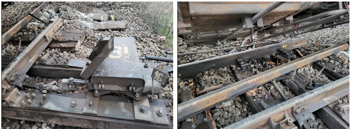
Foto nr.7 și 8. Schimbătorul de cale nr.16 afectat de deraiere
