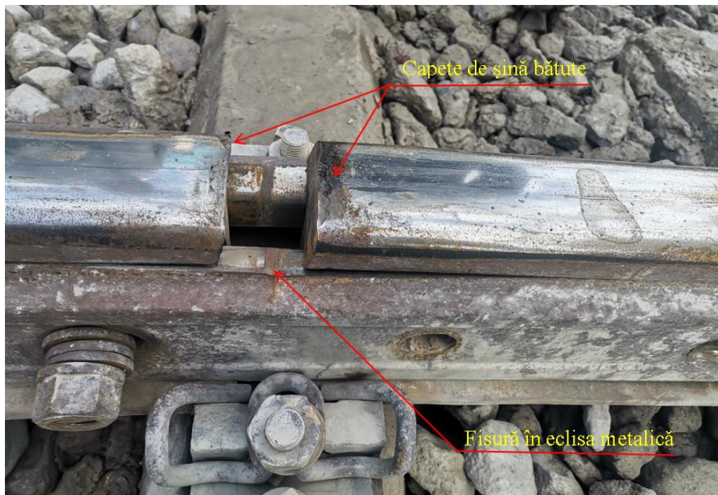
Foto nr.5. Capete de șine bătute în dreptul joantei și fisură în eclisa metalică
