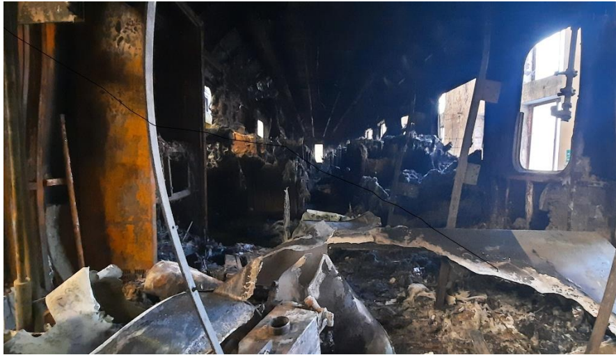
Imaginea nr.9 – interiorul vagonului afectat de incendiu
