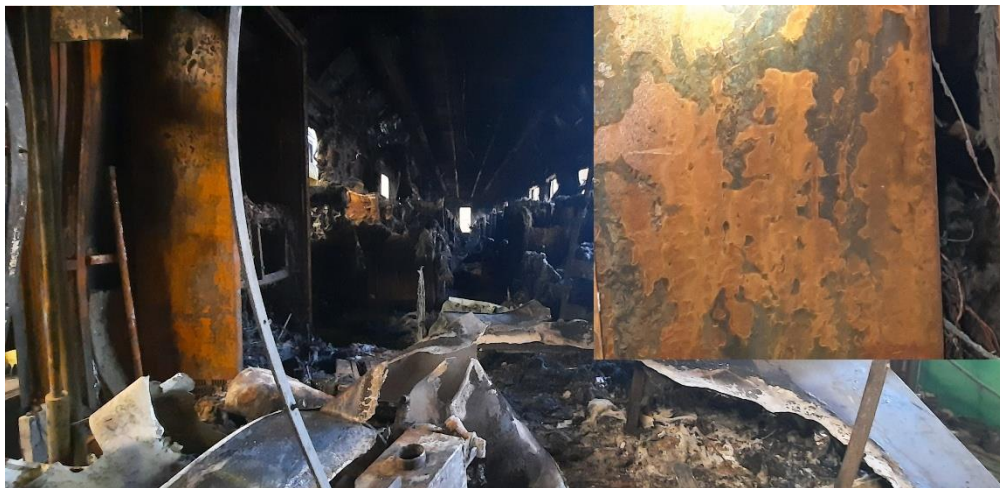
Imaginea nr.10 – zona tabloului electric de comandă al vagonului cu detaliu al afectării termice a cutiei acestuia
