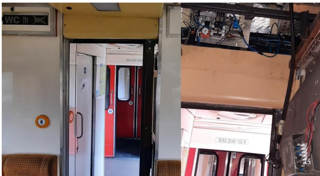
Imaginea nr.15 - Instalația electropneumatică de deschidere a ușii salonului de la un vagon similar
