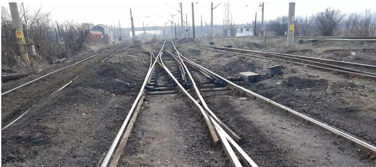
Imaginea nr.14 - starea liniilor în capătul X al stației CFR Turceni
