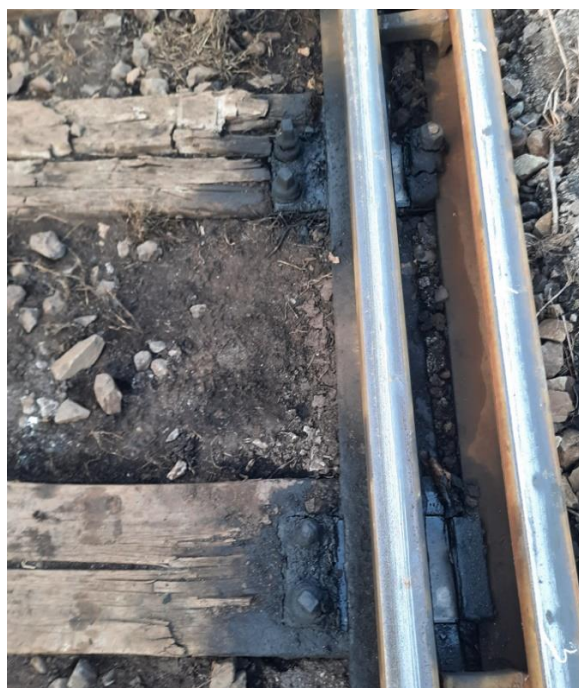
Imaginea nr.10 – partea dreaptă a traverselor care susțin contraacul curb
