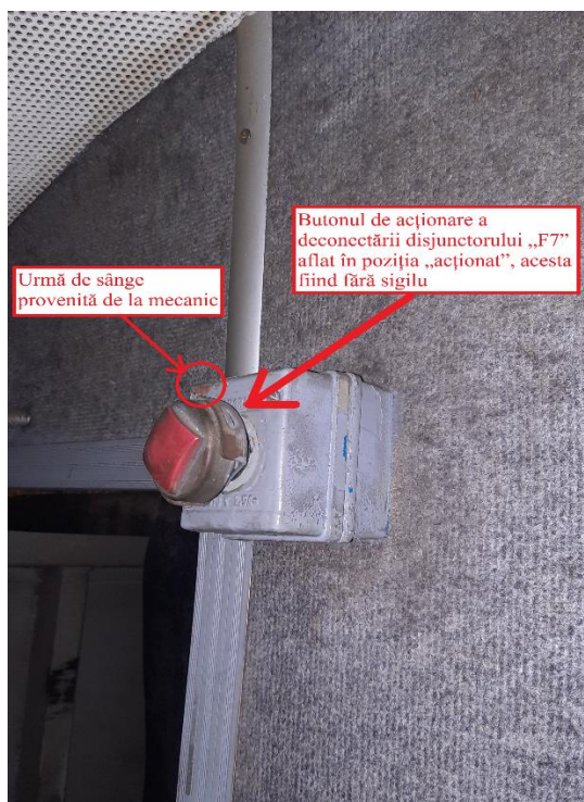
Foto nr.2 - butonul de acţiune a deconectării disjuncteurului „F7”
