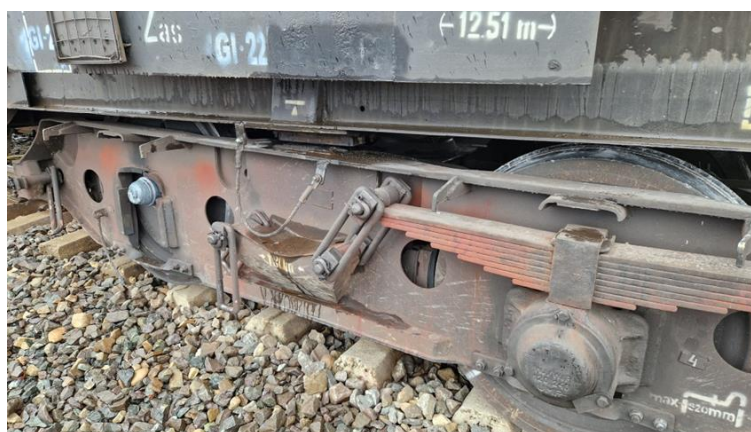
Foto nr.1-boghiul deraiat al vagonului nr.83537963122-8
