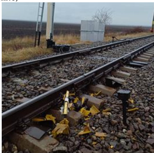
Foto nr. 6- inductor de 2000 Hz avariat
