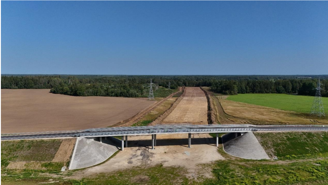
Foto 2. Kuku viadukt, Hagudi-Kodila tee ning põhitrassi rajamise ettevalmistustööd Rapla maakonnas. (Foto: Rail Baltic Estonia OÜ projektijuht Kuldar Aavastik)
