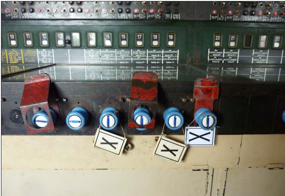
Abbildung 5: Hebelwerk E 43 mit Merkhinweisen und Hilfssperren
