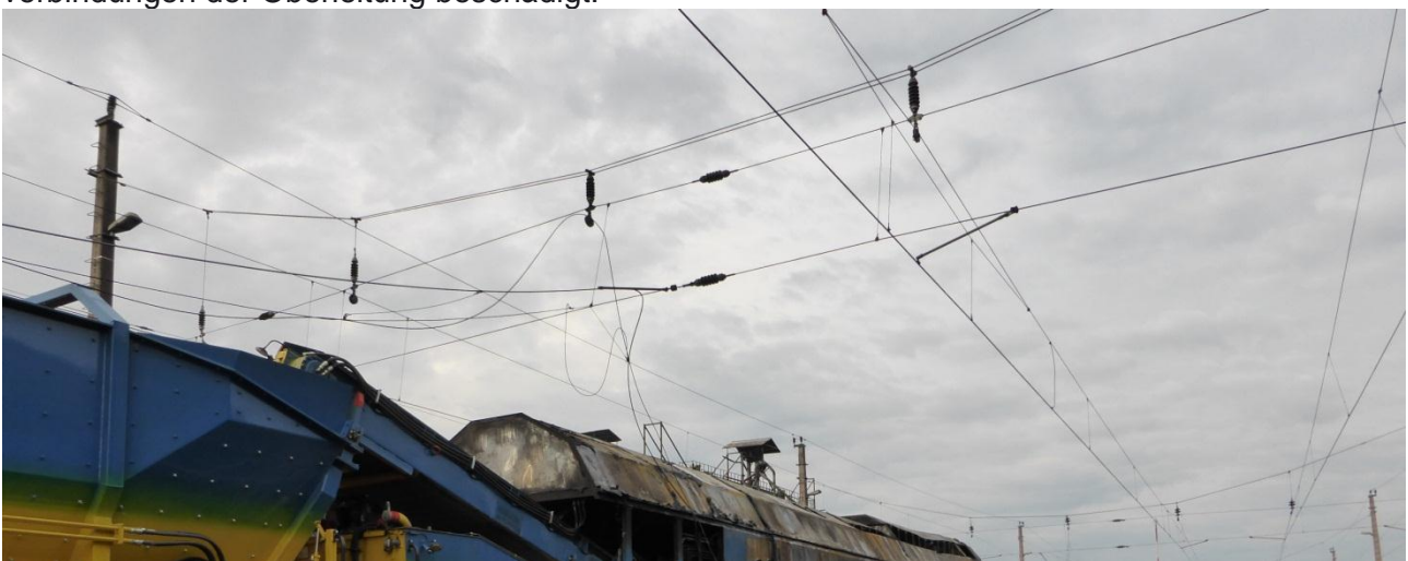
Abbildung 20: Beschädigte Oberleitung (Quelle IM)
