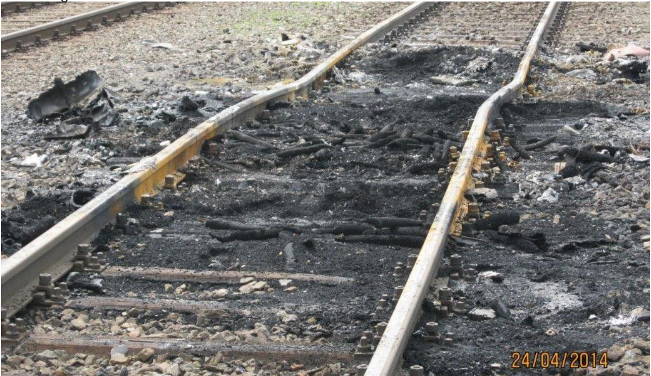
Abbildung 19: Beschädigter Oberbau (Quelle IM)
