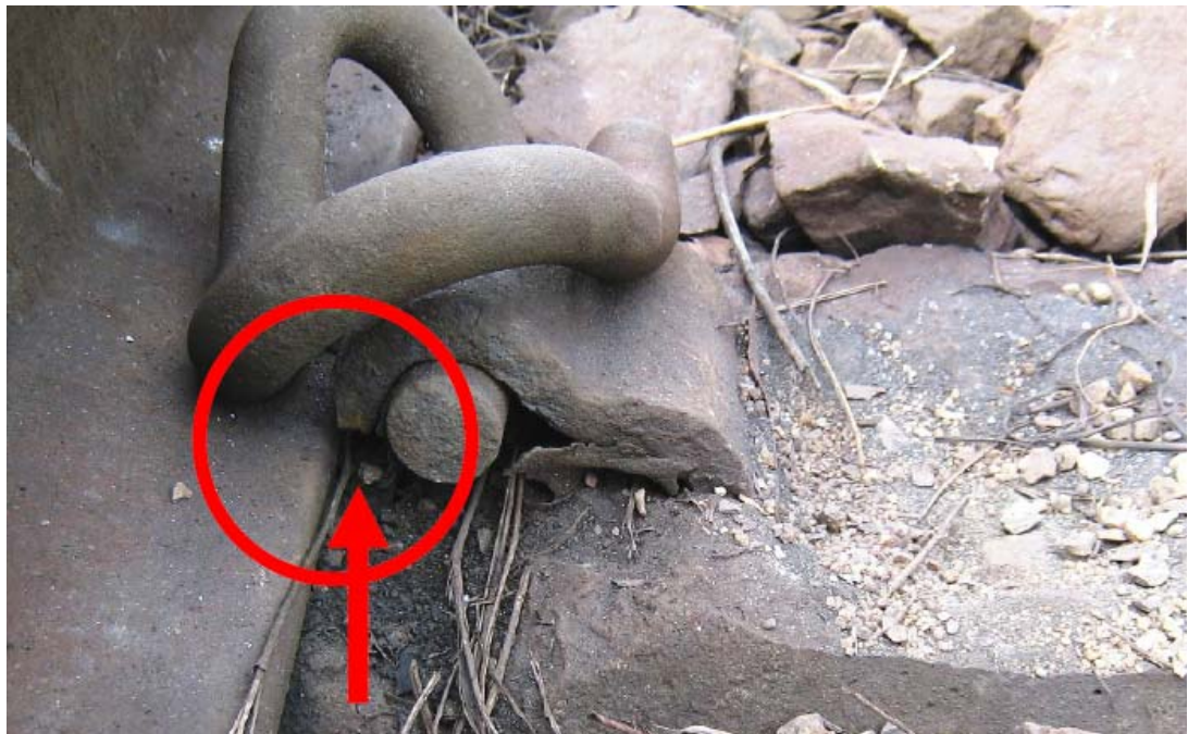
Abb. 16 Weitere Rissstelle an einer Schienenbefestigung ca. 15 m vor der Entgleisungsstelle
