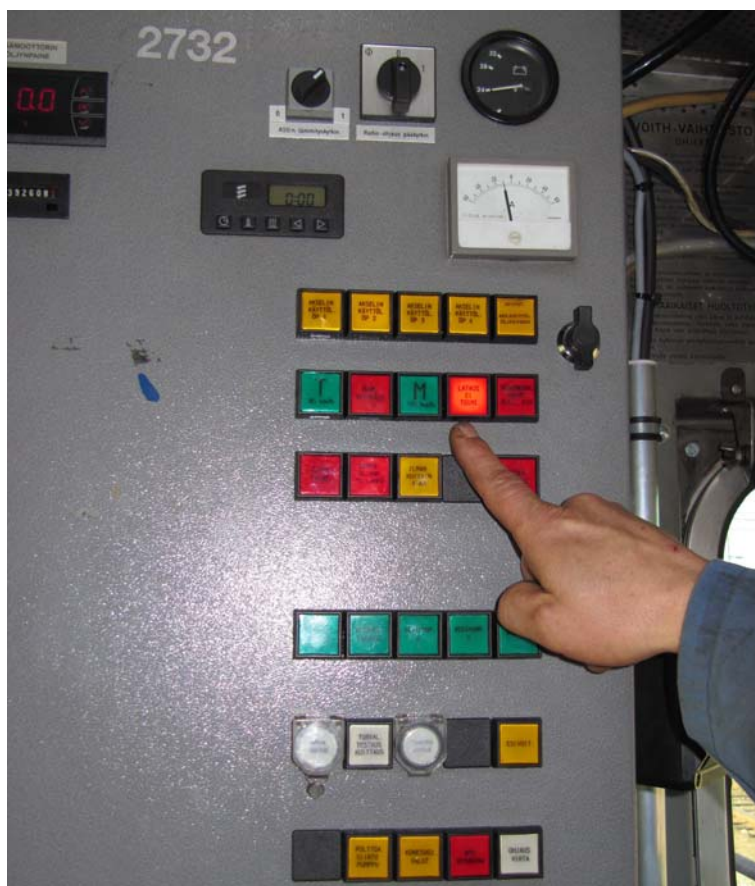
Kuva 3. Veturin I-ohjauspöydän vieressä oleva ohjaustaulu, kun laturi ei lataa. Lataus ei toimi -merkkivalo palaa, ampeerimittari osoittaa purkautumista ja jännitemittari näyttää 24 V.
