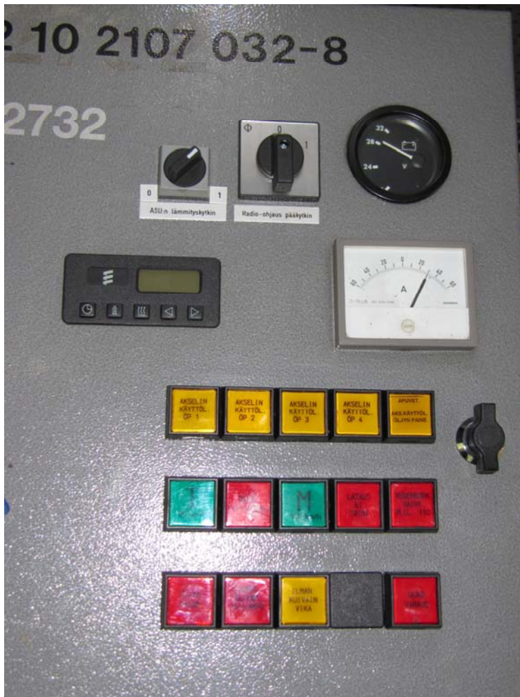
Kuva 4. Ohjaustaulu laturin ladatessa. Lataus ei toimi -merkkivalo ei pala, ampeerimittari osoittaa latausta ja jännitemittari näyttää 28 V.
