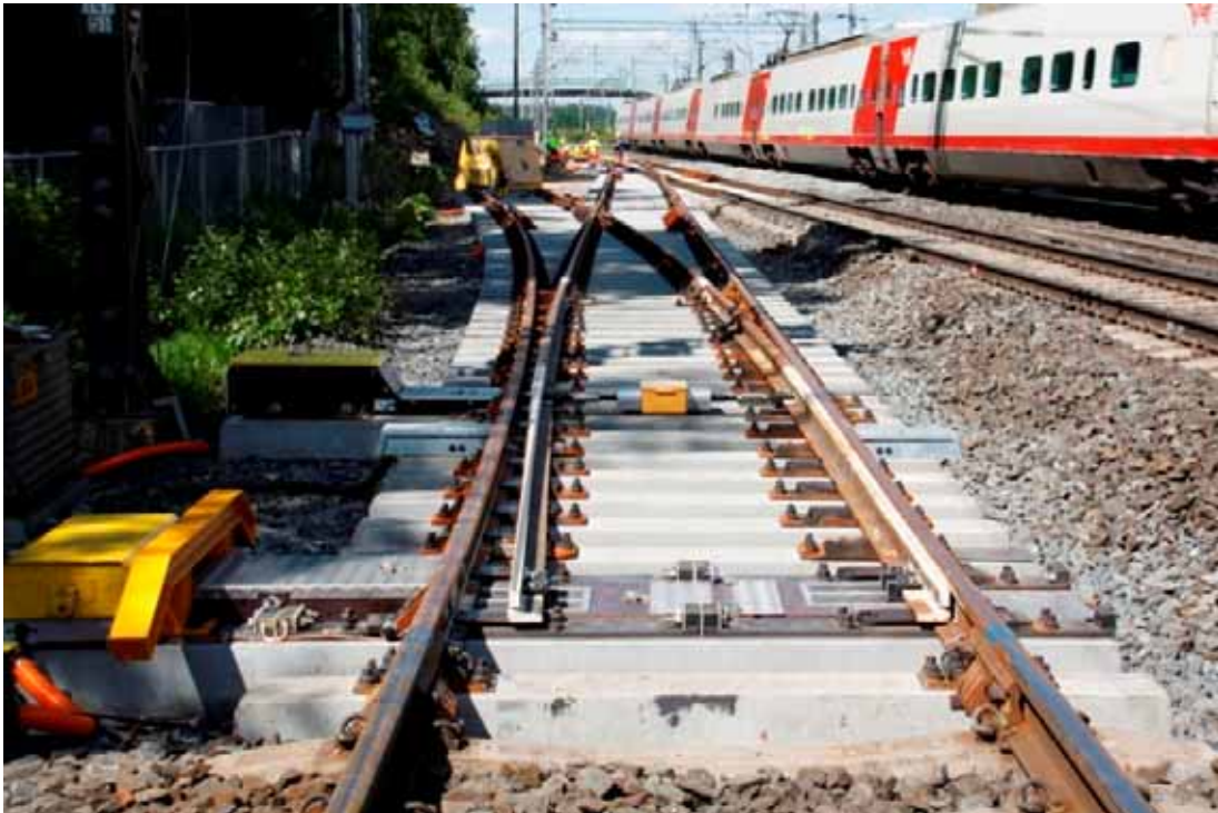
Kuva 10. Onnettomuuden jälkeen uusittu vaihde V004. Vaihteen kielet olivat kääntyneet junan alla kuvan mukaiseen asentoon.
