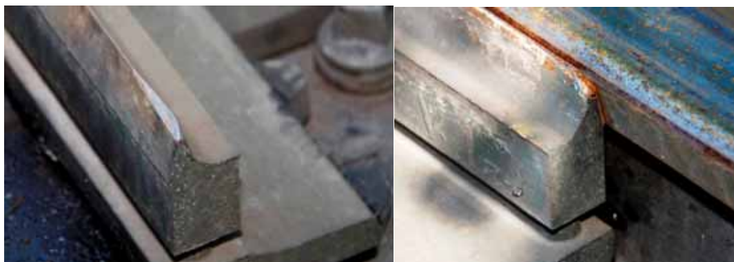
Kuva 11. Vasemmanpuoleisessa kuvassa pyörän laipan iskemäjälki vaihteen vasemman kielen kärjessä. Oikeanpuoleisessa kuvassa oikean kielen kärjessä oleva pieni murtuma.
