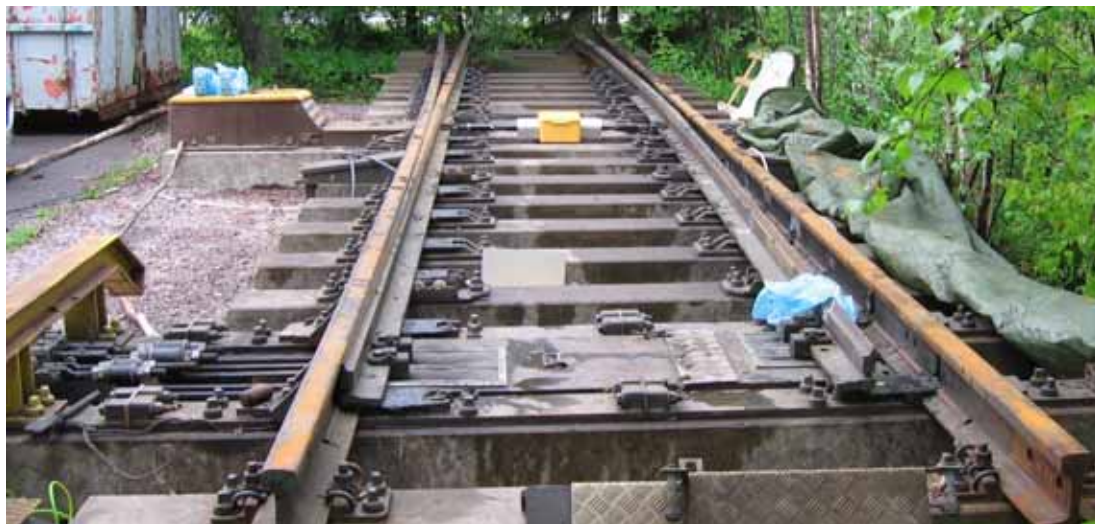
Kuva 14. Vaihte siirrettynä tutkimuspaikalle tarkastuksia ja testauksia varten. Vaihte käännettynä asentoon, jossa se oli junan saapuessa vaihteelle.
