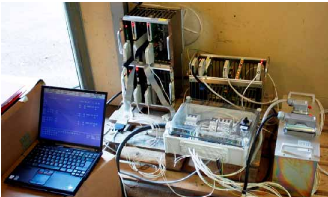
Kuva 17. Vaihteenkäännön testilaitteisto. Vasemmalla kannettava tietokone asetinlaitteen ja ohjausyksikön välisien sanomien ja häiriöiden simulointiin. Takana vasemmalla tietoliikennelaitteet ja oikealla vaihteen ohjausyksikkö.
