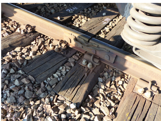
Foto: slechte staat van de dwarsliggers op de spoorstaaf aan de uitzetvoeg - overzijde van POD 1.
