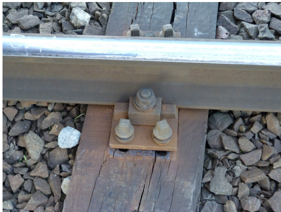
Foto: een verschoven onderlegplaat (recent) met geovaliseerde boorgaten (niet recent) tegenover POD 2.
