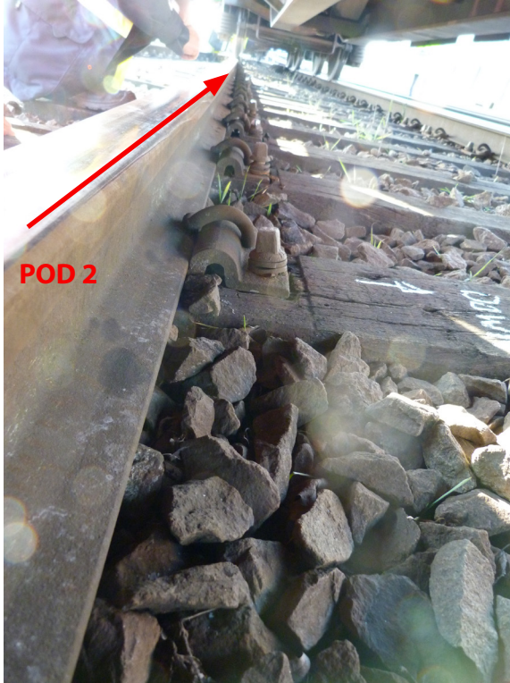
Foto links POD 2: 2de ontsporing van het linkerwiel van de eerste bogie van de locomotief.
