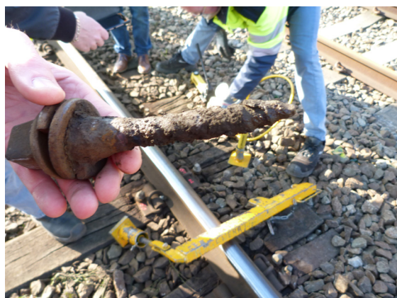
Foto: sterk gedegradeerde staat van sommige losse kraagschroeven ter hoogte van de POD.
