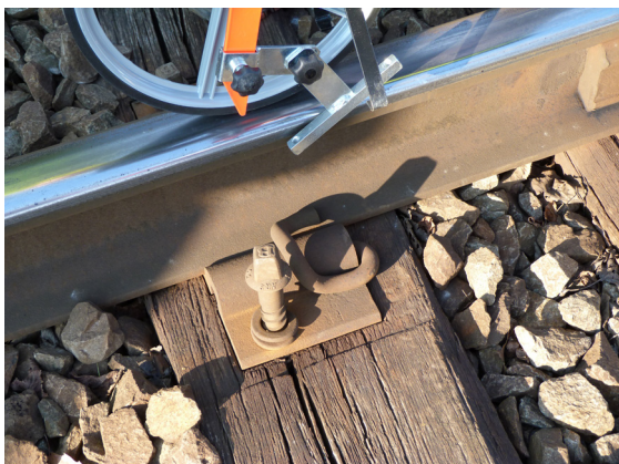
Foto: uitgetrokken kraagschroef ter hoogte van POD 1.
