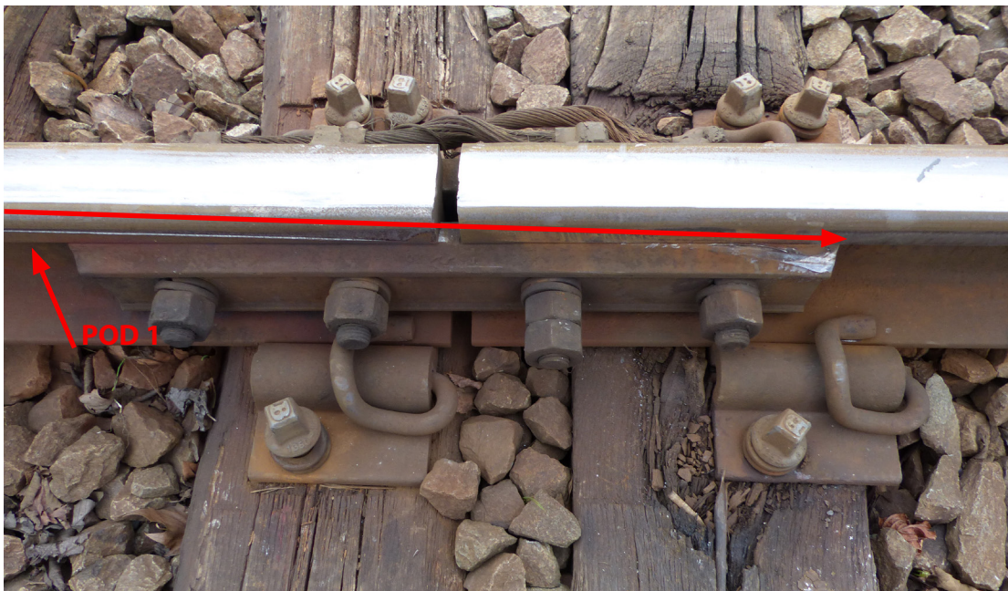
Foto zij aanzicht POD 1: de ontsporing van een wiel aan uitzetvoeg van het linkerbeen van het spoor A.
