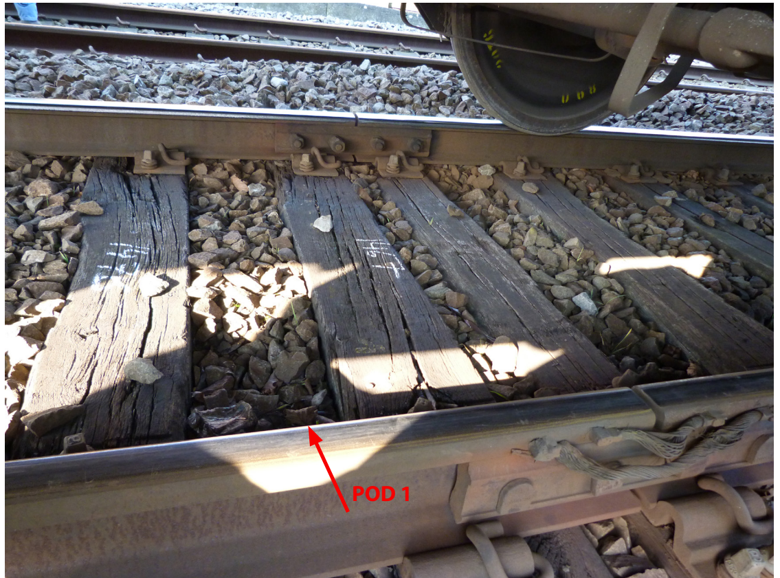
Foto: lasplaten aan de overzijde van POD1: de veerringen zijn niet samengedrukt.
