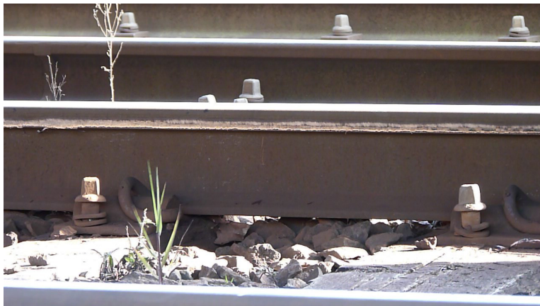
Foto: uitgetrokken kraagschroeven na POD 2.
