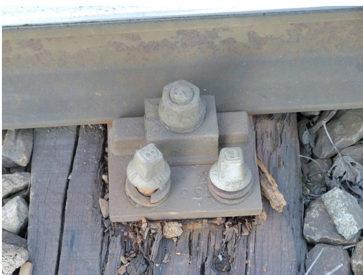
Foto: slechte staat van een dwarsligger, deels uitgetrokken kraagschroef en verschoven pandrolplaat.
