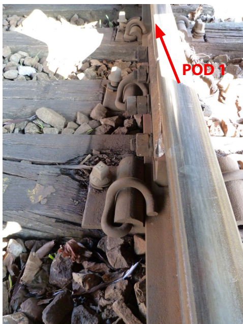
Foto vooraanzicht POD 1: inslag op de lasplaat en 2 uitstekende kraagschroeven en niet samengedrukte veerringen.
