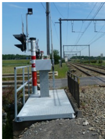
La passerelle nouvellement construite afin de réduire le nombre de grandes alarmes au passage à niveau 28. (Photo prise le 19 mai 2020).
