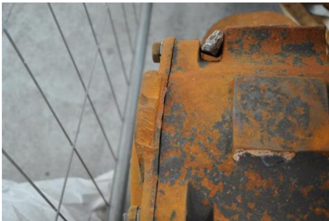
Figuur 50 : Gebroken stuk aan de deksel van de wielasbus van wiel B
