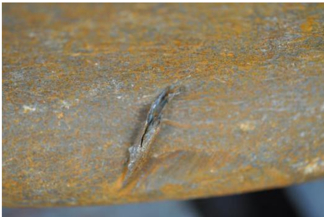
Figuur 16 : Slag van ongeveer 30 mm aan de binnenkant van de kraag van de wiel A
