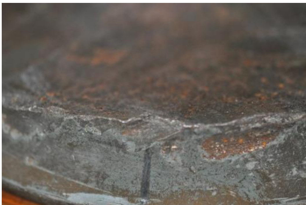
Figuur 103 : Detail van de aanzetpunt van breuk aan de kant A
