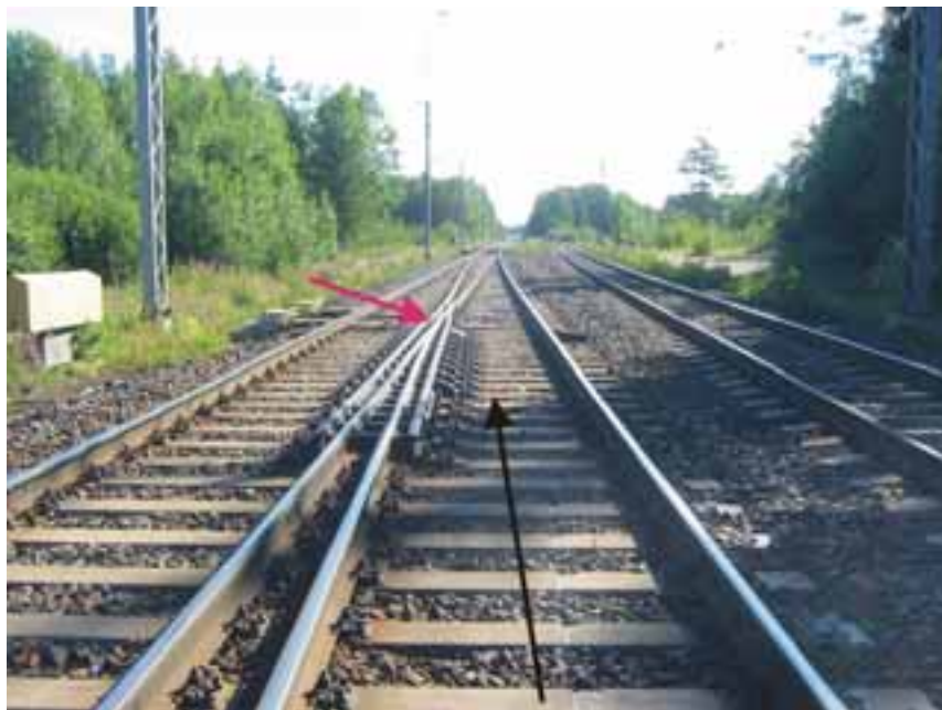
Kuva 3. Junan kulku vaihteen kieliin eteen. Punaisella nuolella on osoitettu vaihteen kääntyväkärkinen risteys, joka on siinä asennossa, jossa se oli junan ajaessa vaihteelle.
