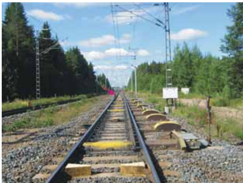
Kuva 4. Vaihte V002 oli kuvan osoittamassa asennossa. Juna pysähtyi nuolen kohdalle ennen vaihteen kieliä, josta kuljettaja lähti työntämään takaisin päin.
