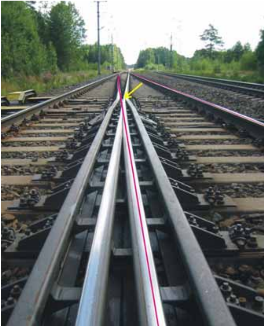
Kuva 5. Vaihteen V002 kääntyväkärkisen risteuksen asento vaihteen ollessa suoralle raiteelle johtavassa asennossa. Junan kulku vaihteen kieliin eteen on kuvattu punaisilla viivoilla. Keltainen nuoli näyttää kääntyvän risteuksen.
