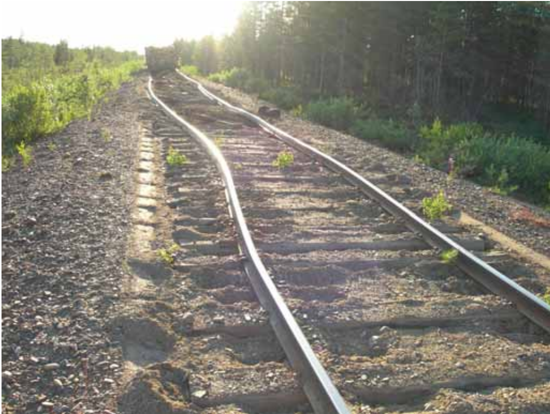
Kuva 3. Suistuneet vaunut rikkoivat radan rakenteen pahoin.
