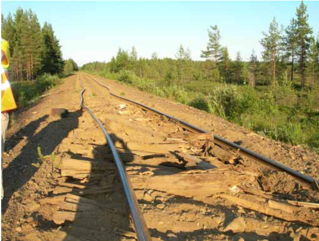
Kuva 4. Radassa suistumisen jälkeen ollut käyrä ja sen jälkeistä rikkoutunutta rataa.
