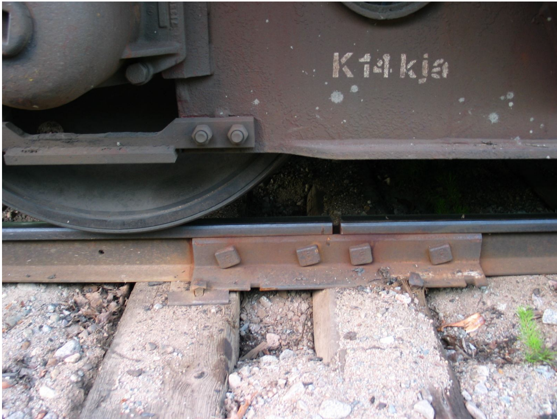
Kuva 7. Kiskon vaelluksen seurauksena kiskoatkos oli siirtynyt ratapölkyn päälle.
