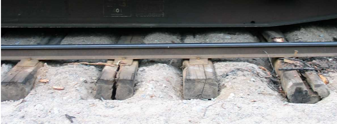
Kuva 5. Kuvassa näkyy ratapölkkyjen huono kunto.
