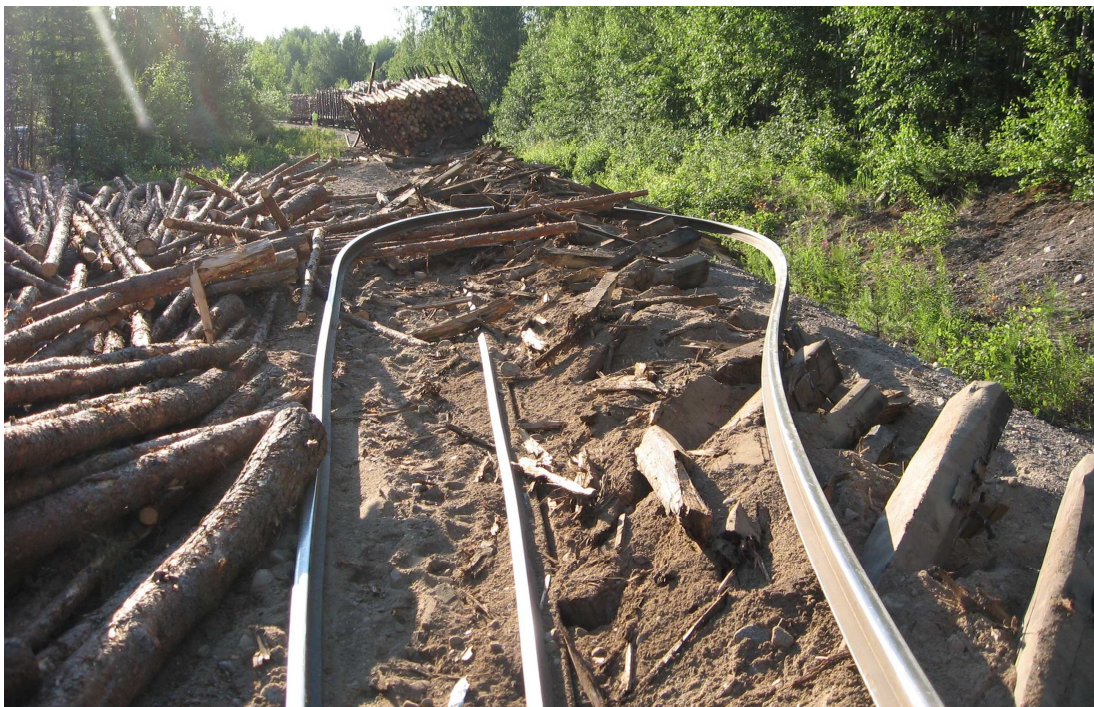
Kuva 4. Vaurioitunutta rataa. Kuvassa näkyy myös katkenneen junan peräpää.
