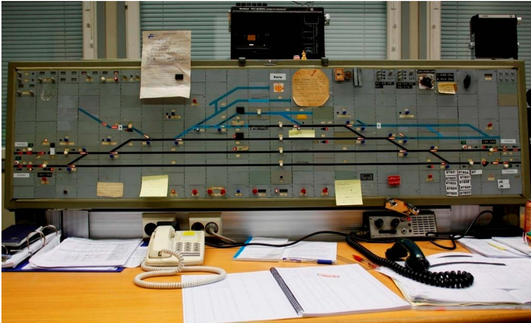
Kuva 9. Korian asetinlaitteen ohjaustaulu.
