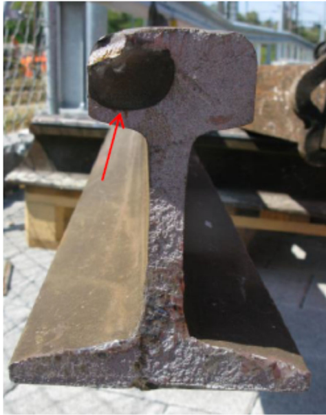
Abbildung 9: Dunkle Anrisszone seitlich im Schienenkopf (roter Pfeil).
