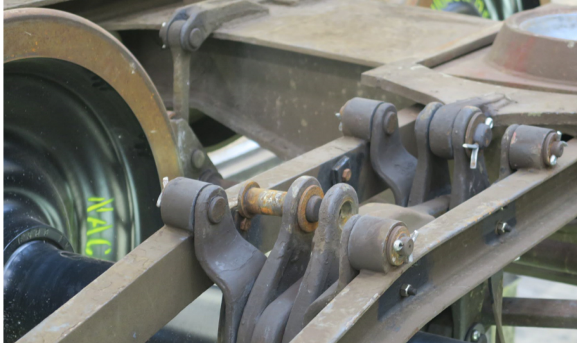
Abbildung 23: Bolzen der Bremsgestänge ohne Schmierung.
