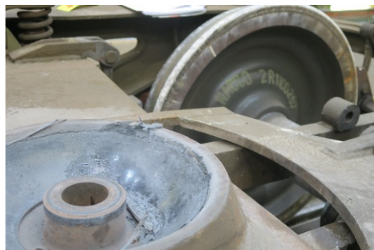
Abbildung 9: Beschädigte Kunststoffgleiteinlage der Drehpfannen und metallische Schleifspuren im oberen Bereich der Drehpfanne.
