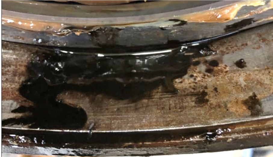
Abbildung 22: Achse 4, rechts, Ölaustritt, Detail im unteren Bereich des Achslagergehäuse nach der Öffnung des Deckels.
