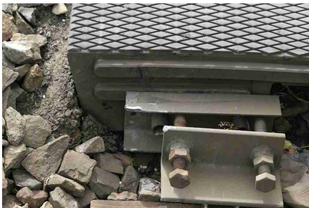
Obr. č. 14: Stopy po nárazu do čela konstrukce přejezdové vozovky přejezdu P 4933
