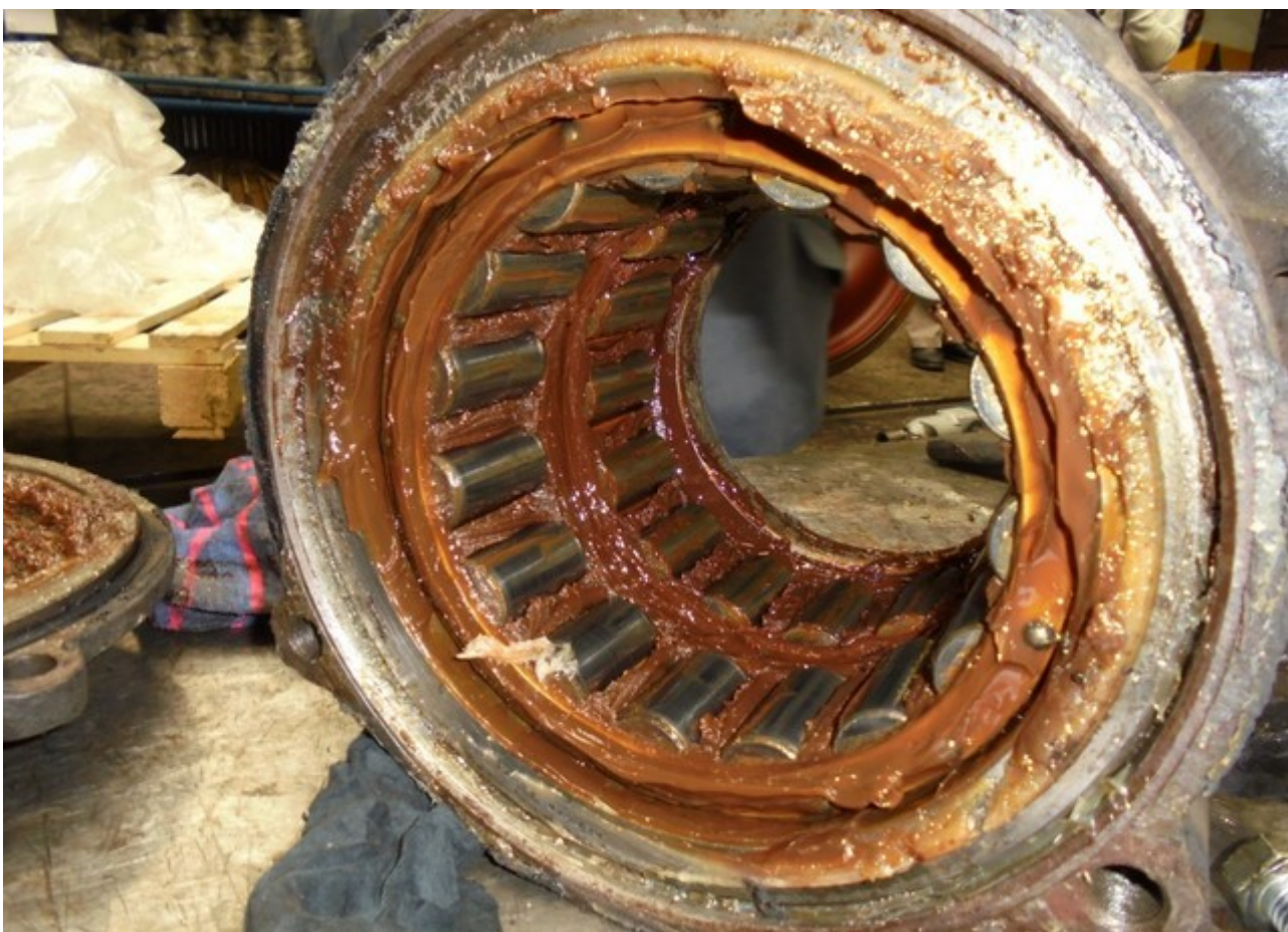
Obr. č. 10: Pravá ložisková komora 3. dvojkolí po vyjmutí zbytku ulomeného čepu
