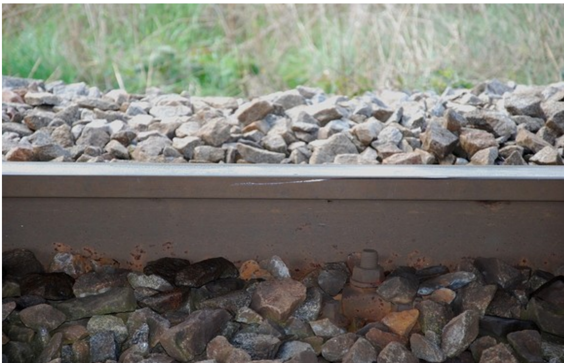
Obr. č. 4: Stopa na pojížděné hraně pravé kolejnice, kde kolo sjelo z temena kolejnice.
