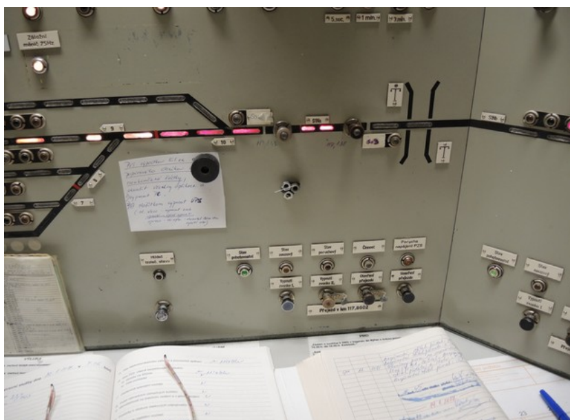
Obr. č. 7: Panel SZZ v žst. Vejprnice
