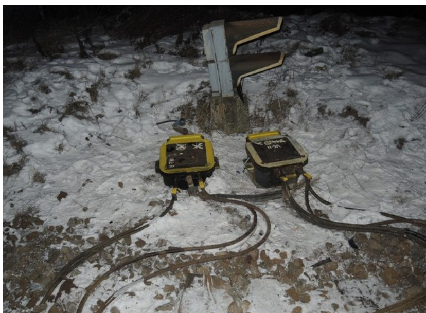
Obr. č. 5: Poškozené napájecí kabely kolejových obvodů
