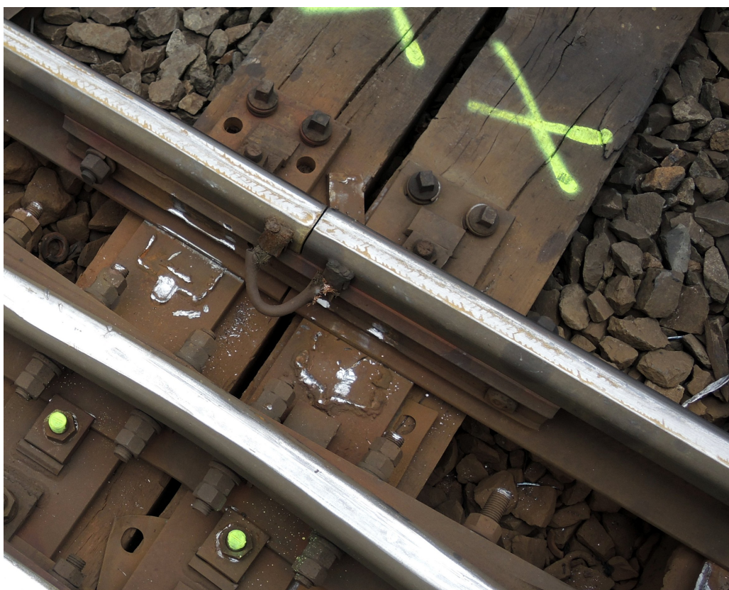
Obr. č. 4: Svary na podkladnicích zajištěných pro expertizu.
