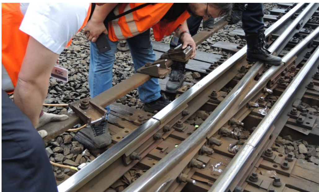
Obr. č. 9: Přídržnice výhybky č. 8a/b u místa odkud byla vymrštěna. Zdroj: Dražní inspekce
