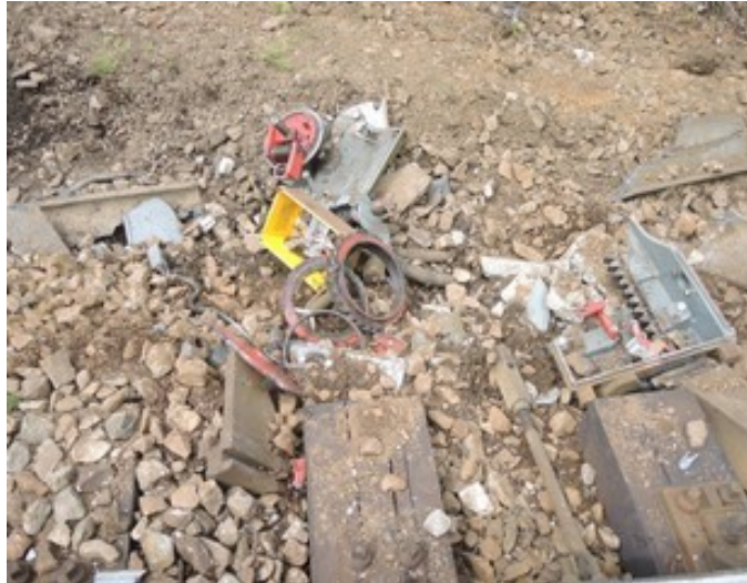
Obr. č. 11: Pohled na trosky přestavníku a výhybky č. 49
