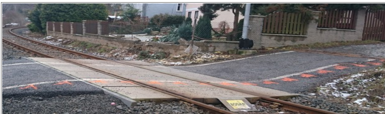
Obr. č. 11: Sklon přilehlé místní komunikace na ŽP P5508
