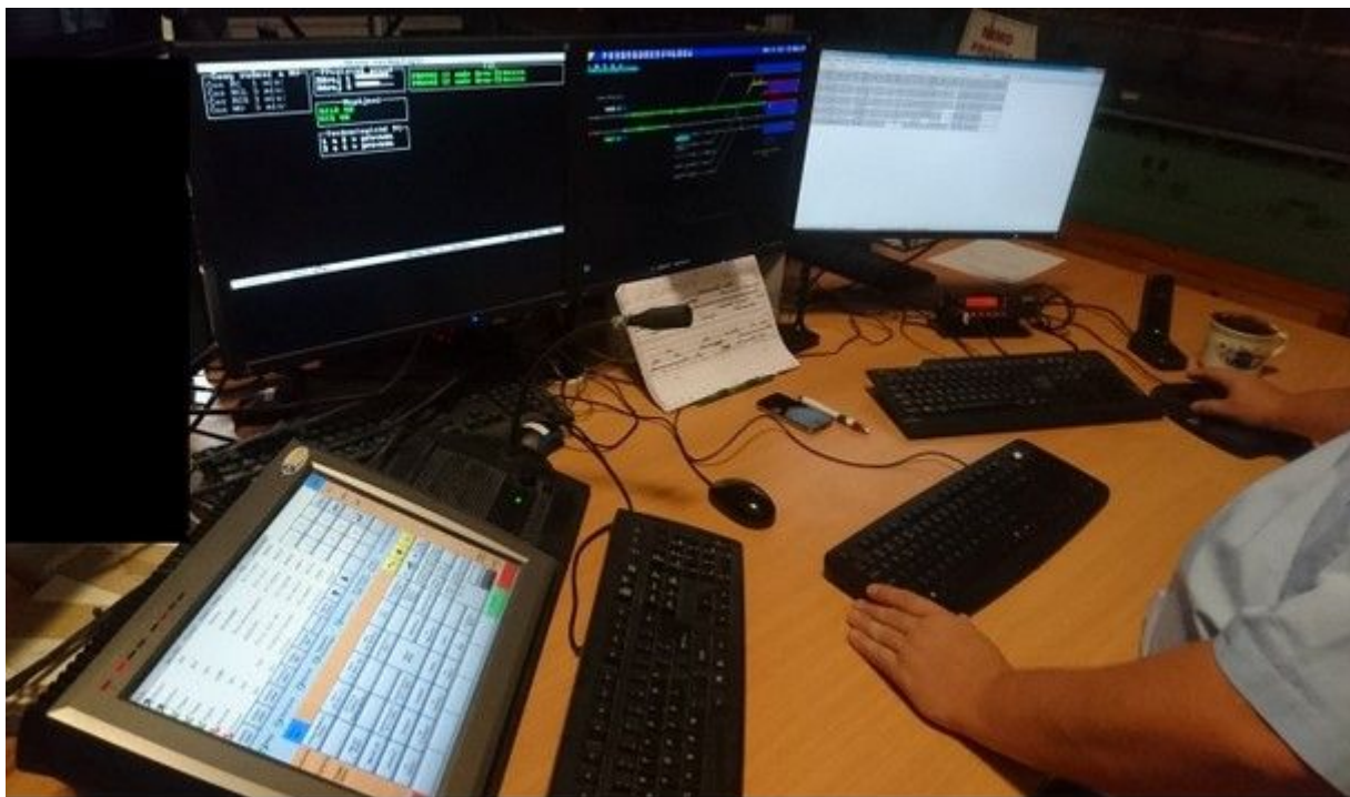
Obr. č. 10: Pohled na pracoviště výpravčího v žst. Brno hl. n.
