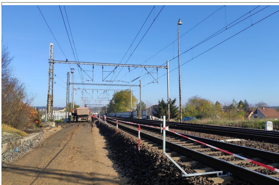
Obr. č. 6: Pohled na prostor (po otažení vlaku Os 9318), kde se nákladní automobil otáčel, a na červenobílou pásku oddělující pracovní místo od pojižděné 0. koleje
