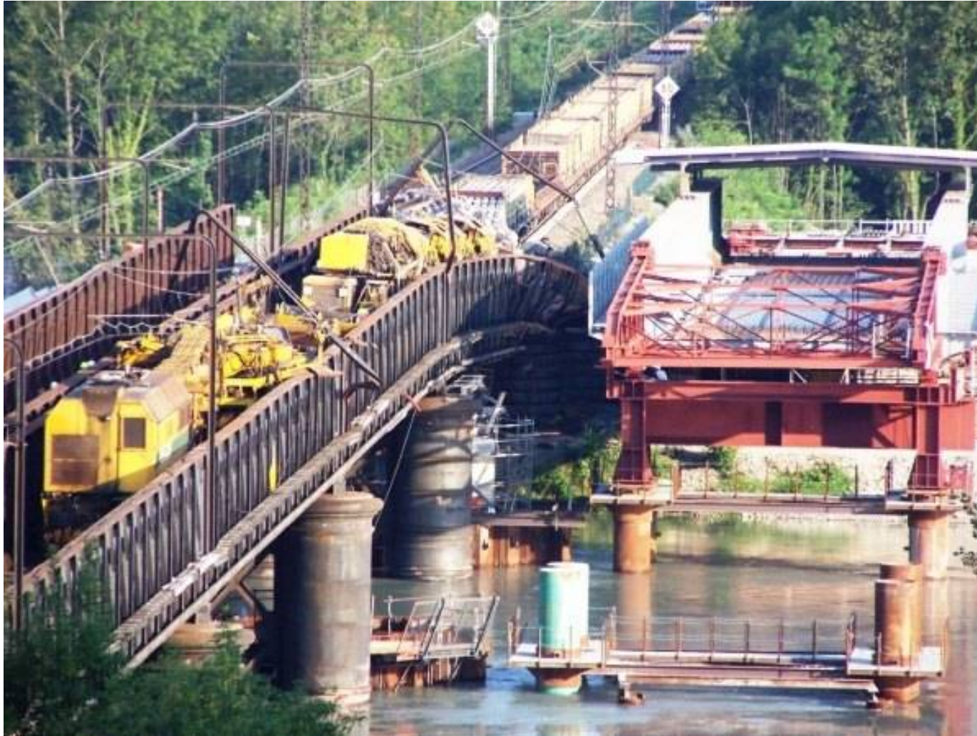
annexe 2-2 : vue aérienne du pont sur le Rhône accidenté
