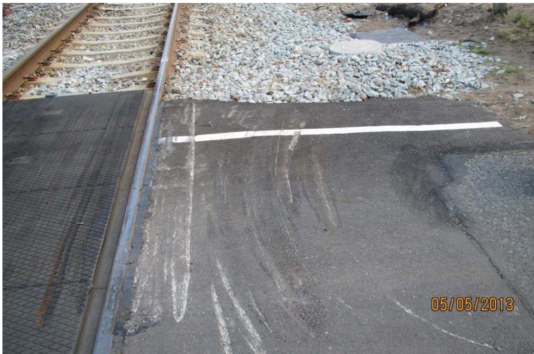
5 Skrabemærker på kørebanen i overkørslen
