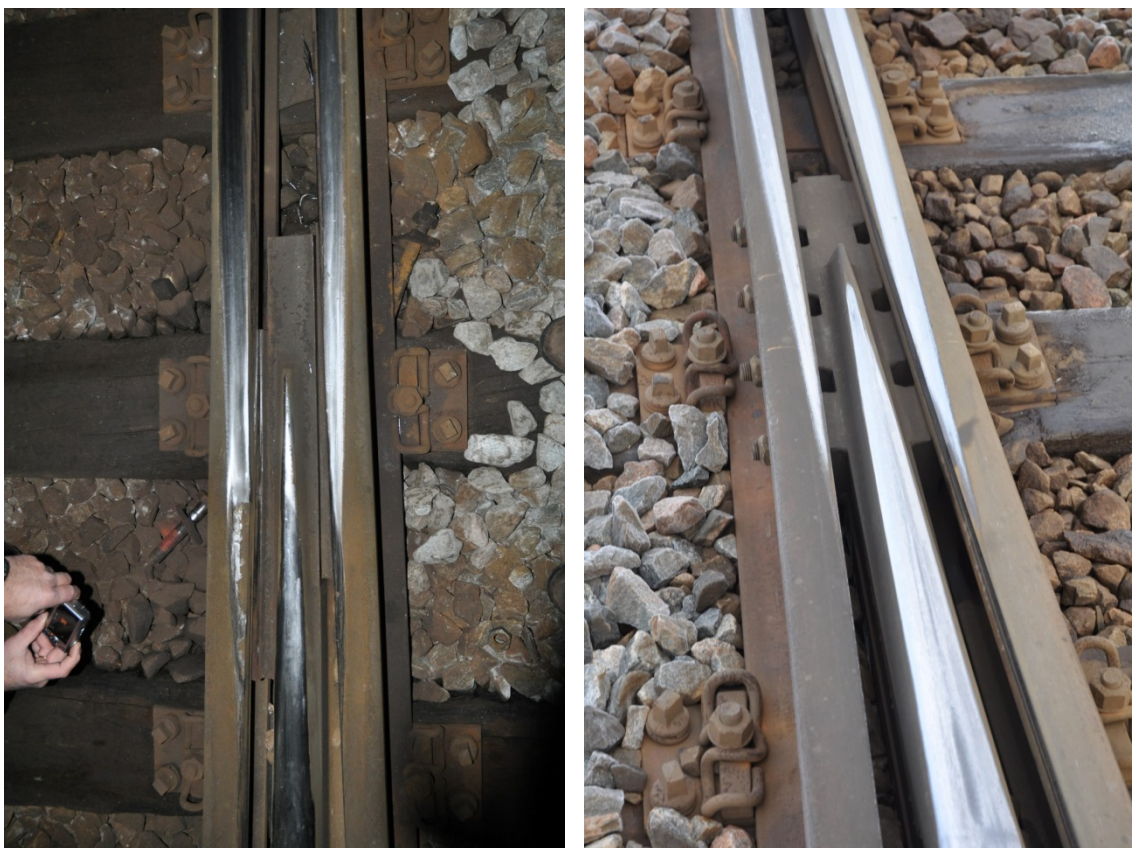
Foto 5 Skinnekrydsninger spsk 101 til venstre og 102 til højre. Bemærk det ujævne slid på sporskifte 101
