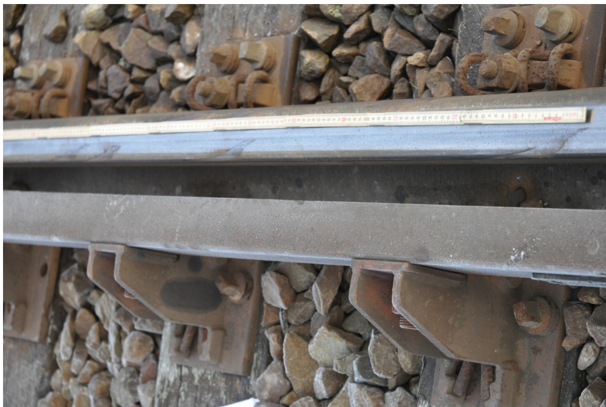
Foto 6 Afsporingmærker - hjulene er afsporet til venstre (opad på billedet) for skinnen
