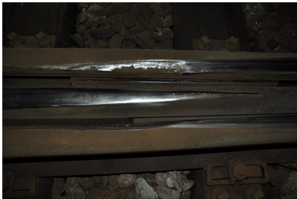
Foto 7 Afskalningen på vingeskinnen, lige ud for hjertespiden. Derunder ses spor af hjulflangers berøring med hjertespidsklodsen
