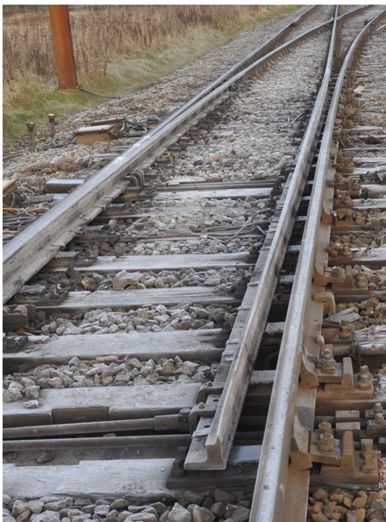
Foto 1 Sporskifte 101 efter afsporingen set mod togets køreretning. Skinnekrydsningen ("hjerterestykket") ses øverst til højre
