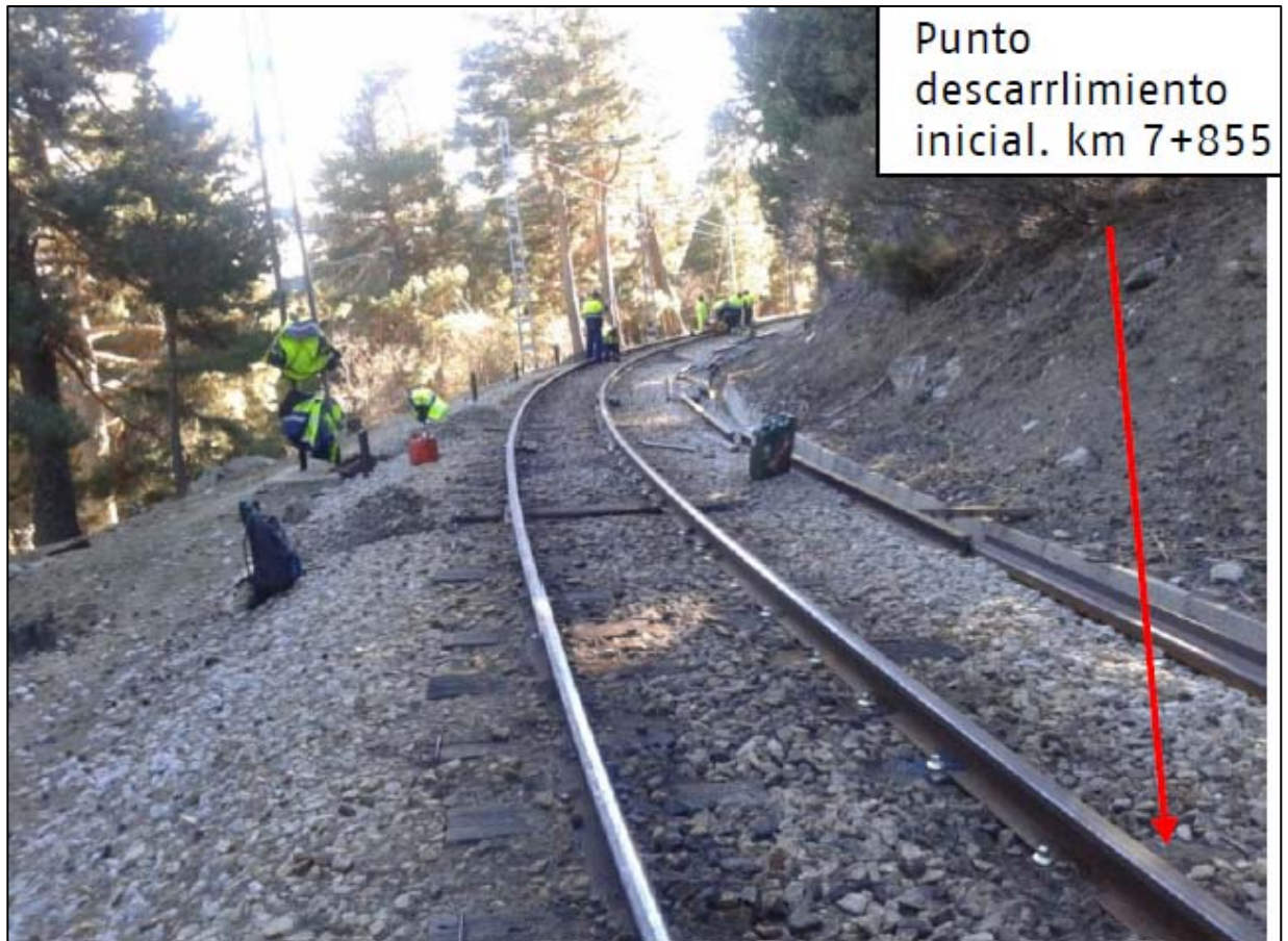
Vista de la zona donde se inicia el descarrilamiento. Fuente Adif.
