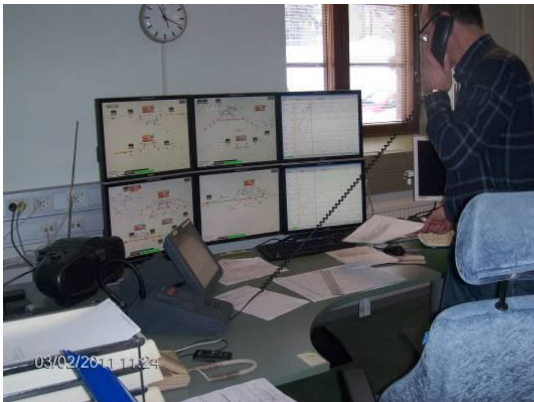
Kuva 24. Joensuu–Nurmes-rataosan liikenteenohjaajan työpiste.
