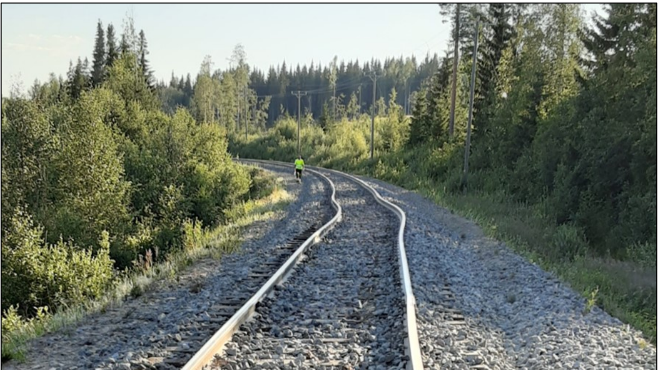
Kuva 7. Tavarajunan vaunujen suistumisalueen toinen radan sivuttaissiirtymä. Valokuva on otettu Humalamäen tasoristeykseltä Haapamäen suuntaan. (Kuva: OTKES)
