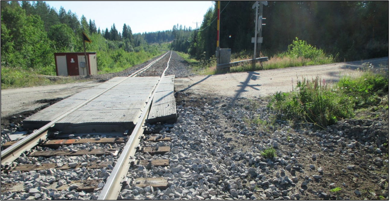
Kuva 6. Suistuneiden vaunujen aiheuttamat vauriot Humalamäentien tasoristeyksessä. Valokuva on otettu Humalamäen tasoristeykseltä Haapamäen suuntaan. (Kuva: OTKES)
