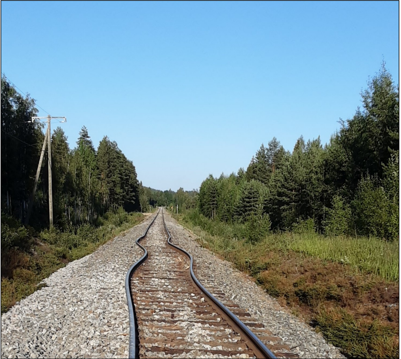
Kuva 5. Tavarajunan vaunujen suistumispaikka on kuvassa näkyvän raiteen sivuttaissiirtymän eli hellekäyrän kohdalla ratakilometrillä 0363+0050. Kuva on otettu Jyväskylän suuntaan, eli junan tulosuuntaan. (Kuva: OTKES)
