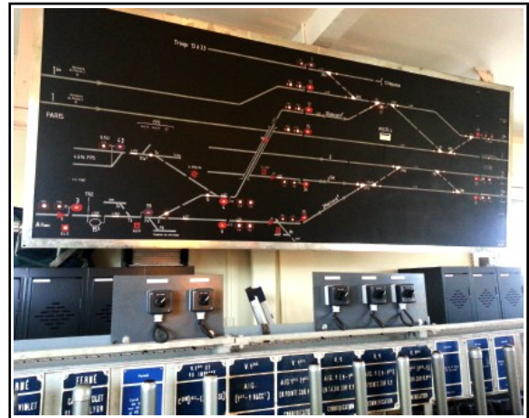
2- Le tableau de contrôle optique du poste
