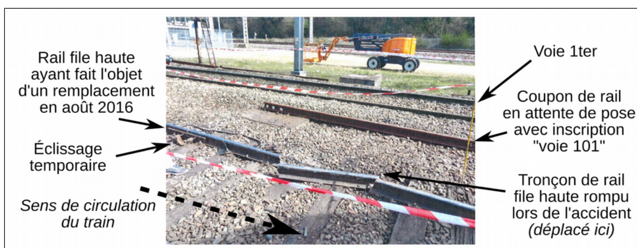
Figure 16 : le rail file haute rompu
