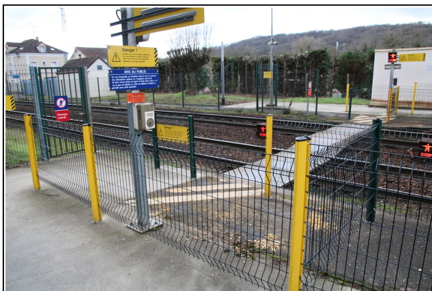
Figure 22 : dispositif installé en gare de Nézel imposant un passage en chicane
