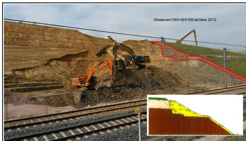
Figure 54 : masque poids du 2 e glissement en coupe lors du terrassement
