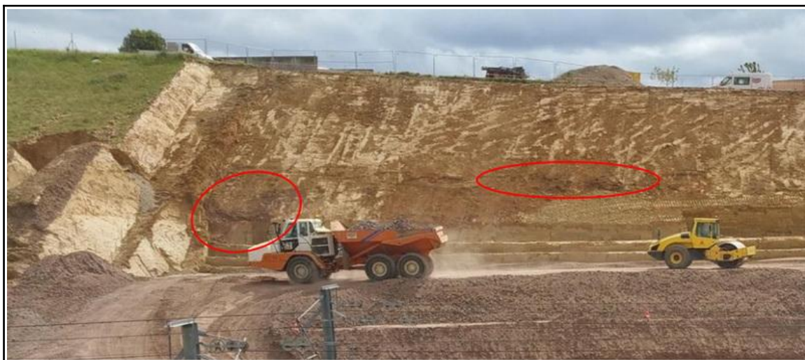
Figure 41 : suintements entre loess et argiles (photo SNCF Réseau le 29/04/20)
