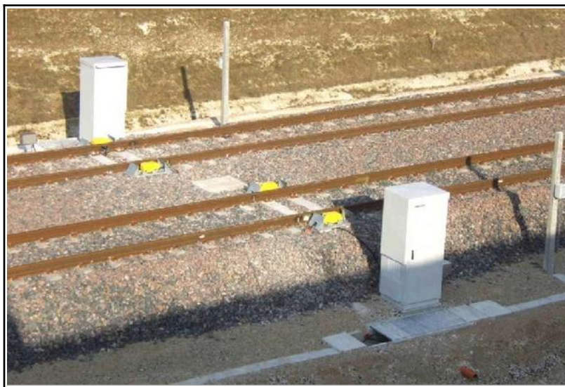
Figure 10 : détecteurs de boîte chaude sur LGV
