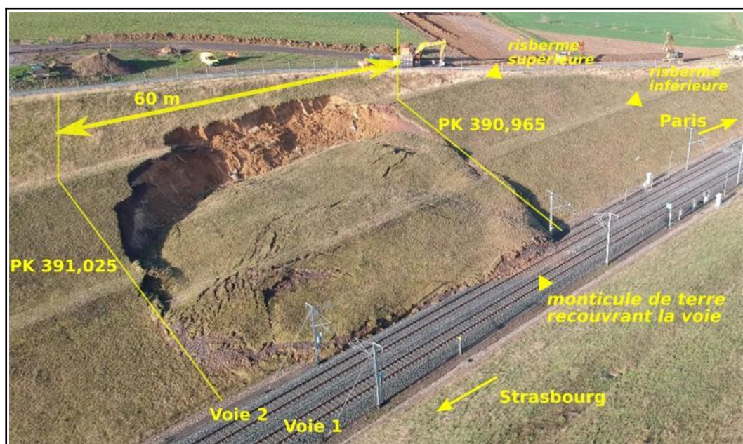
Figure 20 : vue aérienne du glissement du talus
