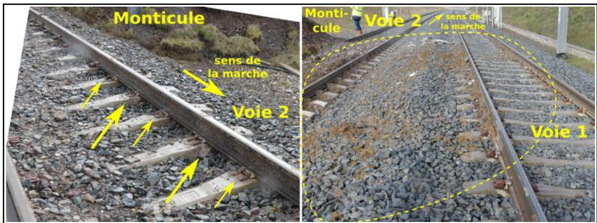
Figure 26 : attaches ôtées et traverses éclatées par le passage de roues (à gauche) et projections de terre (à droite)
