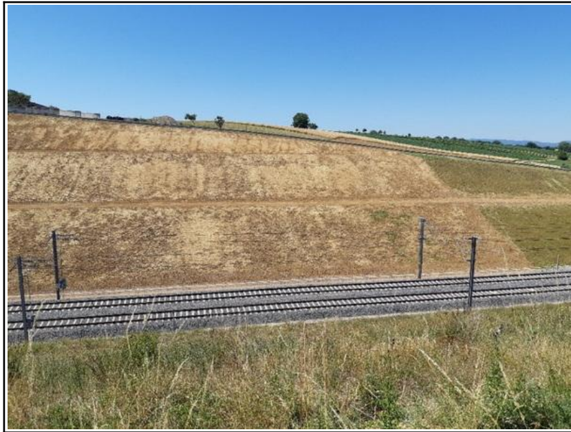
Figure 58 : vue du talus reconstruit
