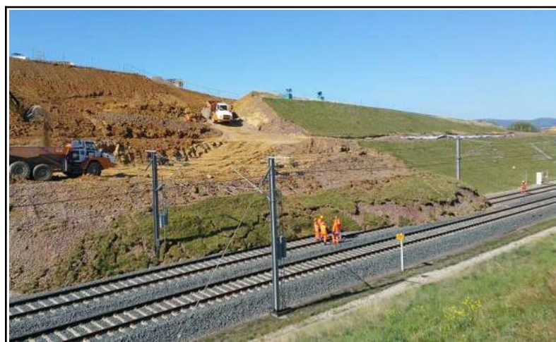
Figure 22 : progression du glissement mi-avril
