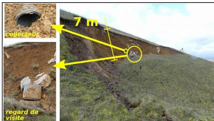
Figure 21 : vue du sommet du glissement
