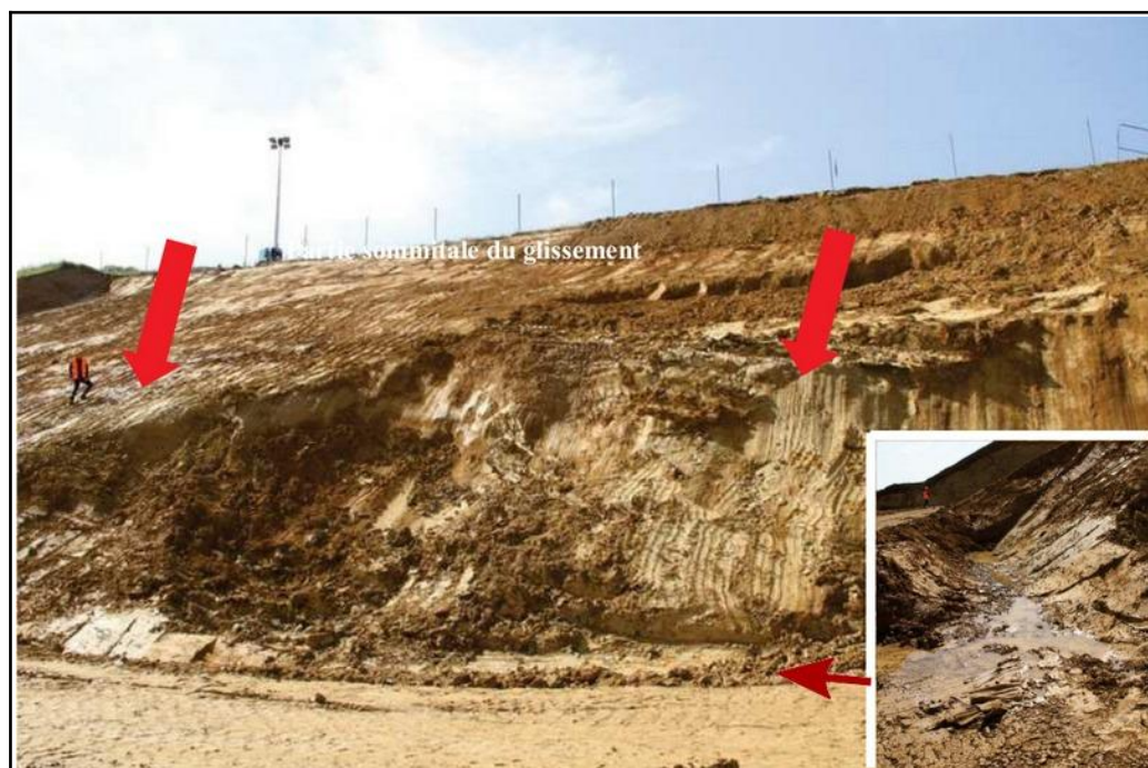
Figure 40 : vue du centre du glissement en cours de terrassement (photos expert judiciaire le 17/04/20)
