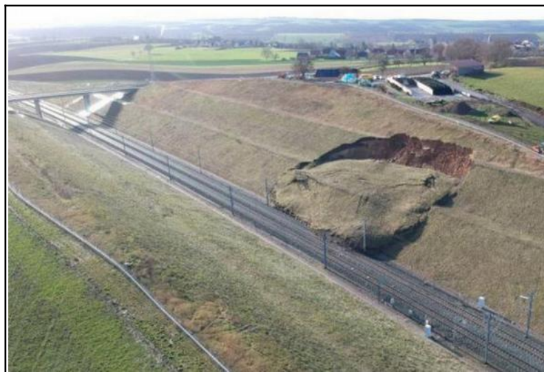
Figure 1 : le talus de déblai effondré quelques heures après l'accident
