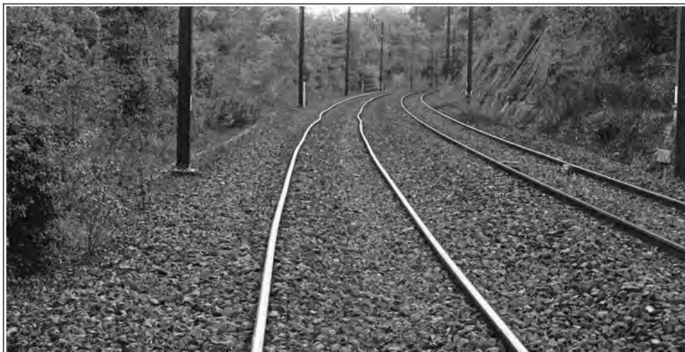
Figure 33 - état de la voie après le déraillement ( dossier judiciaire )
