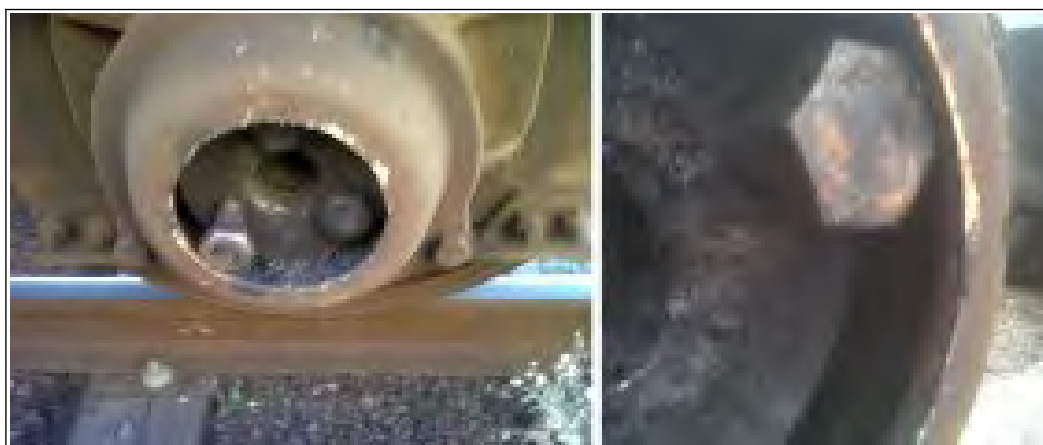
Figure 38 - vues de la boîte trépanée constatée le 9 octobre 2012 (source DB Cargo France)
