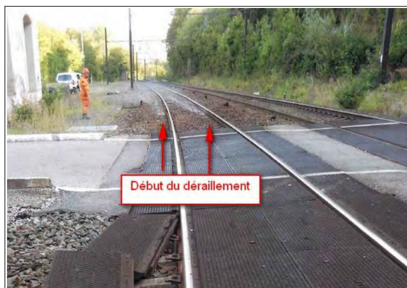
Figure 31 - le point de déraillement immédiatement après le PN 75 (photo SNCF Réseau)
