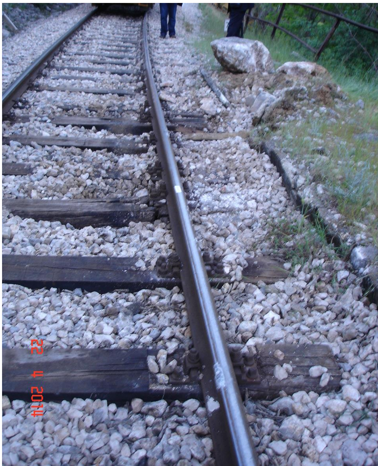
Slika 4 – Oštećenja pruge na mjestu odrona (izvor slike: HŽ Infrastruktura d.o.o.)
