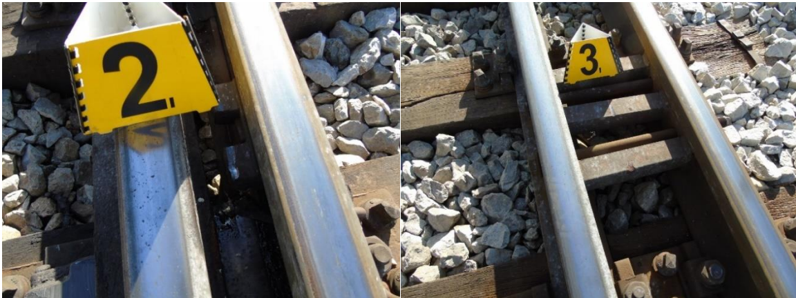
Slika 9. – Oštećenje kod skretnice broj 5 (izvor slike: AIN)
