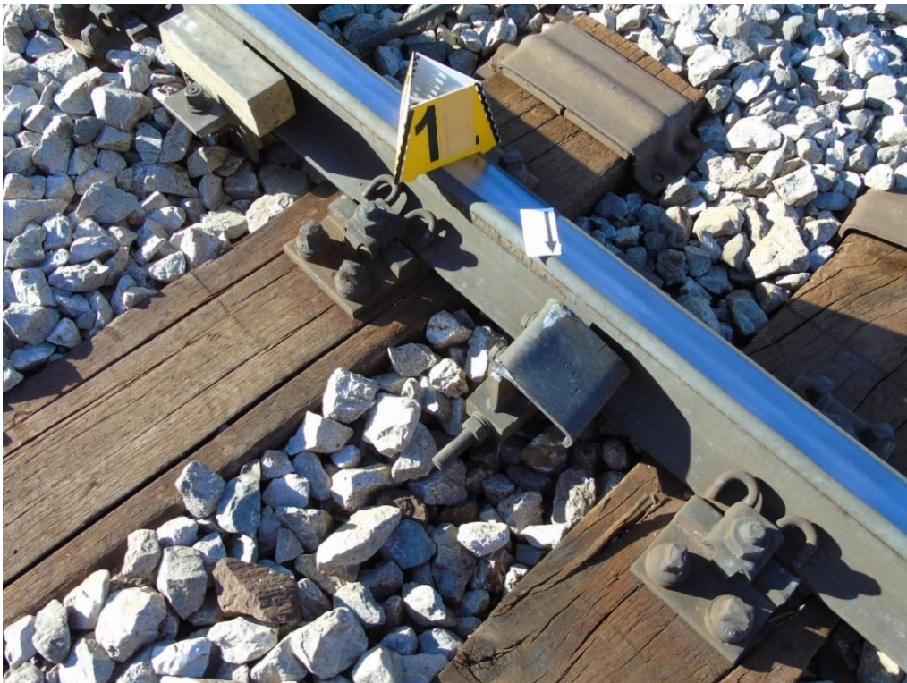
Slika 8. – Oštećen štitnik uključnog kontakta (izvor slike: AIN)
