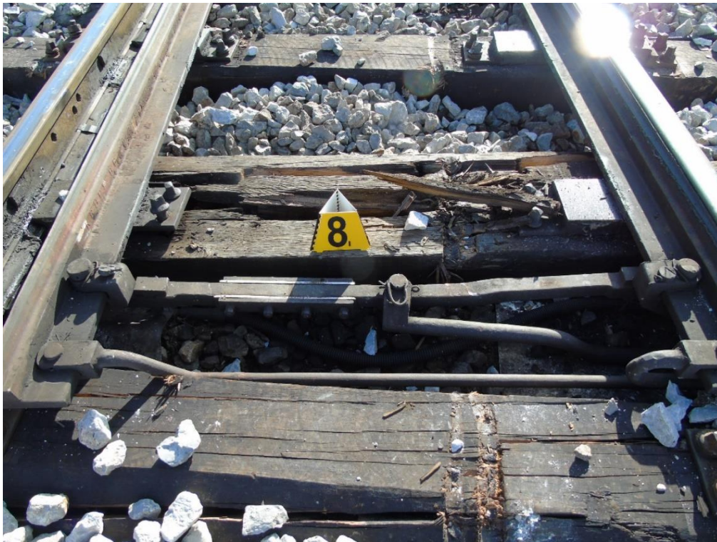
Slika 10. – Oštećenje kod skretnice broj 4 (izvor slike: AIN)
