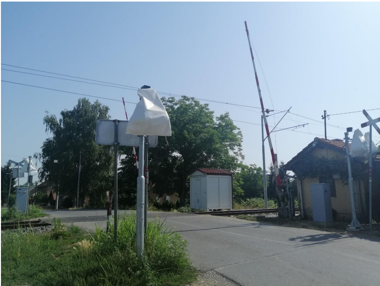
Slika 10. – ŽCP „Pračno“ s novim ugrađenim uređajima osiguranja (Izvor slike: AIN)
