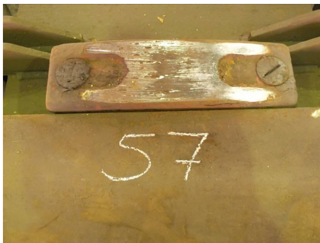
9. ábra: Berágódott oldaltám
