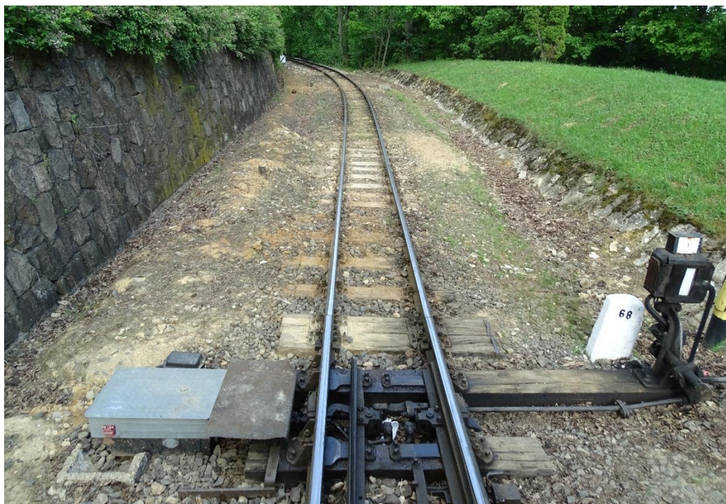
10. ábra: a vasúti pálya a kisiklás helyén, a helyreállítás után (a kisiklott vonat szemből érkezett)
