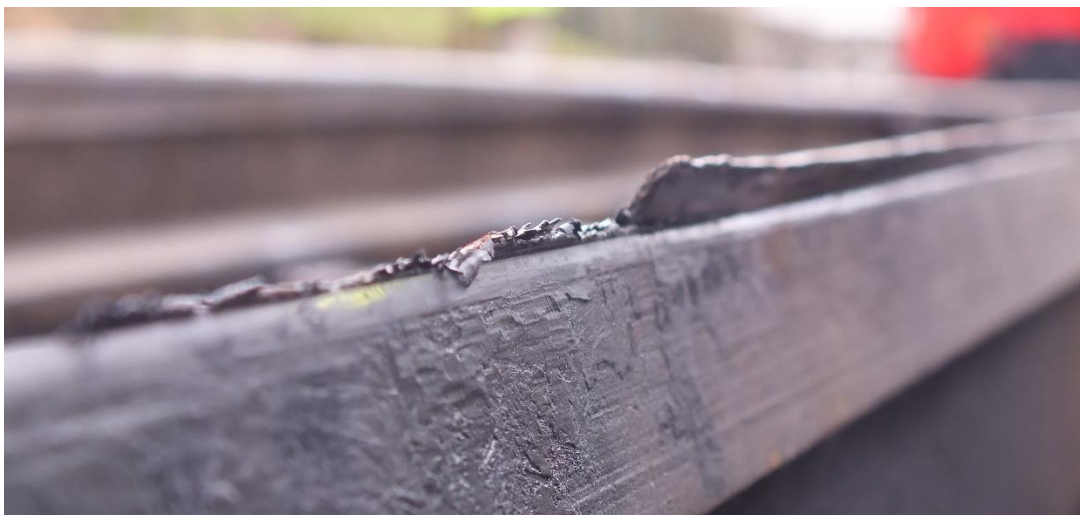
6. ábra: a csúcssín töredezett éle átállítás után
