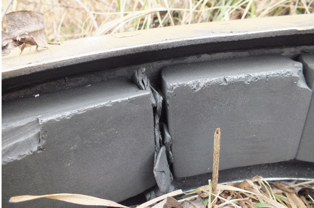
8. ábra: gumiszalag a gumirugók között (helyszíni felvétel)
