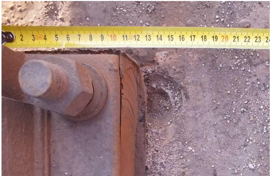
11. ábra: oldalra tolódott leerősítés és beszakadt csavar a burkolt szakasz utáni 10. leerősítésnél
